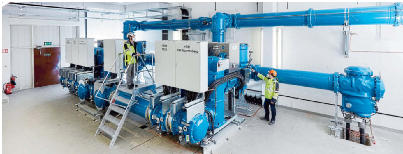
Die Projektleiter Stefan Kronshage (l.) und Hendrik Lohmann zeigen die neue Hochspannungsschaltanlage im Umspannwerk Zwinger. Das Hochspannungskabelsystem wird mit der gasisolierten Schaltanlage (blaue Rohre) verbunden. FOTO: STADTWERKE BIELEFELD/THORSTEN ULONSKA
