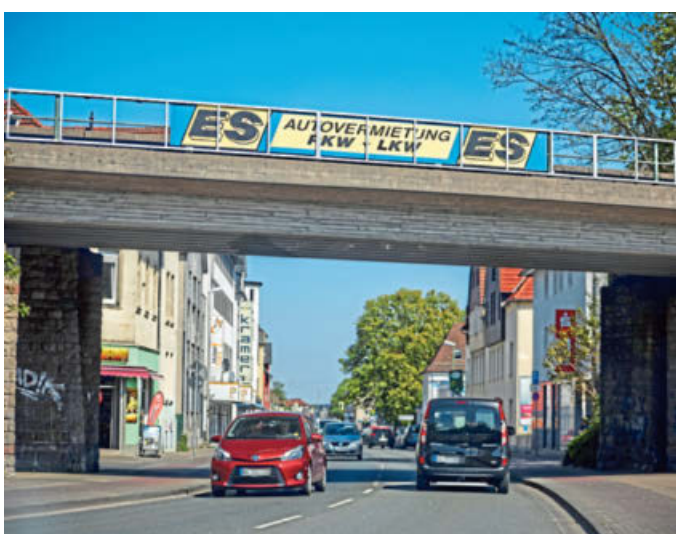
Auf der Heeper Straße wird sich mit dem Umbau einiges ändern: Die Politiker halten den Weg aber für richtig.
